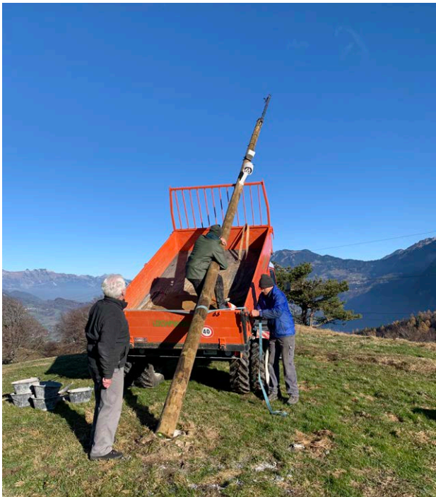
Nach 1982 gibt es auf Lida wieder eine Wetterstation. Ende November 2021 wurde der neue Messmast aufgestellt.
